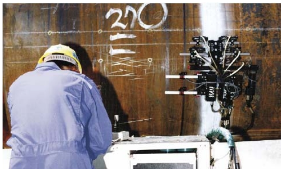
Obr.1 Skenování obvodových svar tlakové nádoby pomocí skeneru a TOFD snímací hlavy UT systému
